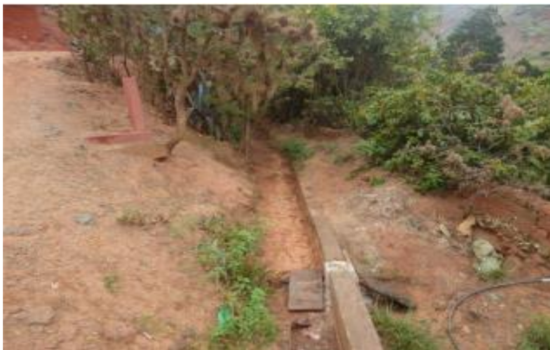
Figura 04. Canal de regadío en desuso y deteriorado.
